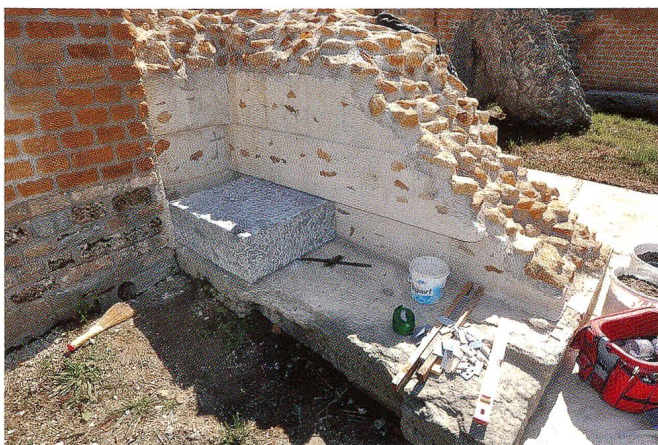
Abb. 14 Aventicum/Avenches (VD), théâtre romain. Aditus sud-ouest, côté nord du mur M93, négatifs des blocs en gros appareil, travaux en cours, 2013.
