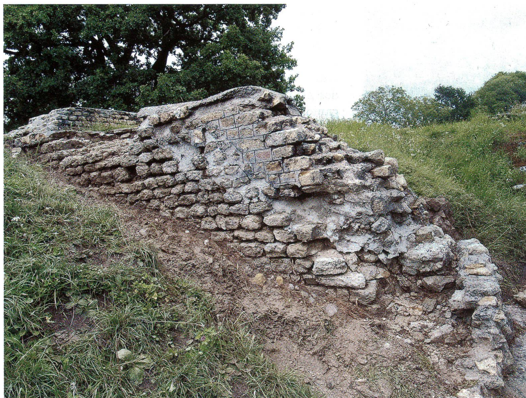
Abb.6 Aventicum/Avenches (VD), théâtre romain. Arrière corps, mur M66, état après retrait de la végétation, les joints d'origine sont totalement dégradés, des ragréages dans les zones où les pierres sont déjà tombées ont été faits (à la limite entre les parties originales et les restaurations du 19 ème siècle), 2009.
