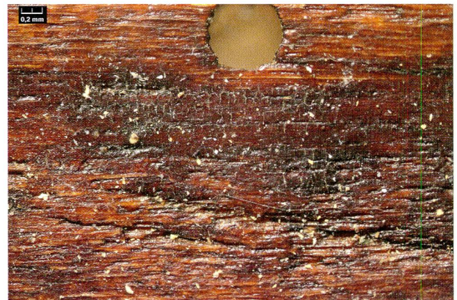
Abb.13 Der bauzeitliche Anstrich bedeckt die Frassränder des Wurmlochs. Oberfläche in 50-facher Vergrößerung, Aufricht.
