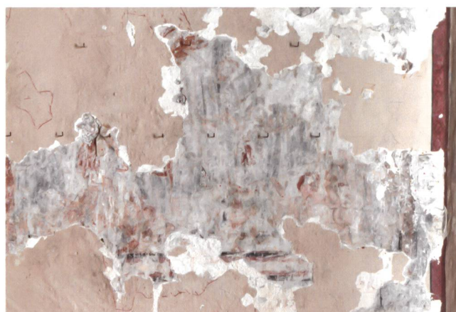
Abb. 12 Nordwand, karolingische Malerei im mittleren Register, Zustand 2010.
