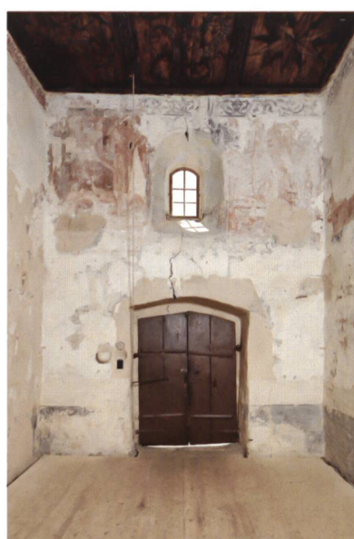
Abb. 6 Westwand, Zustand Juli 2016.
