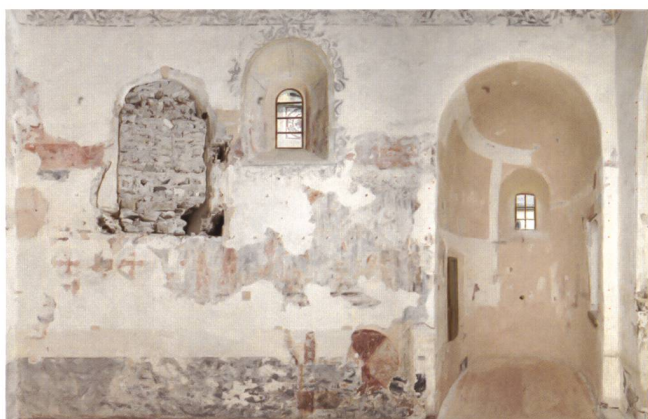
Abb. 3 Nordwand, Zustand Juli 2016.
