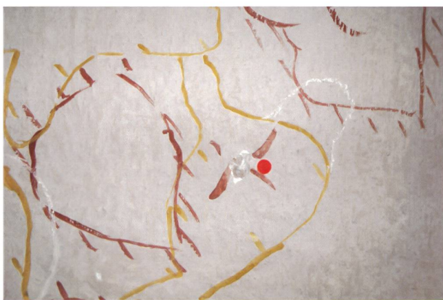
Abb. 14 Südwand, Detail der Hohlstellenkartierung von Oskar Emmenegger.
