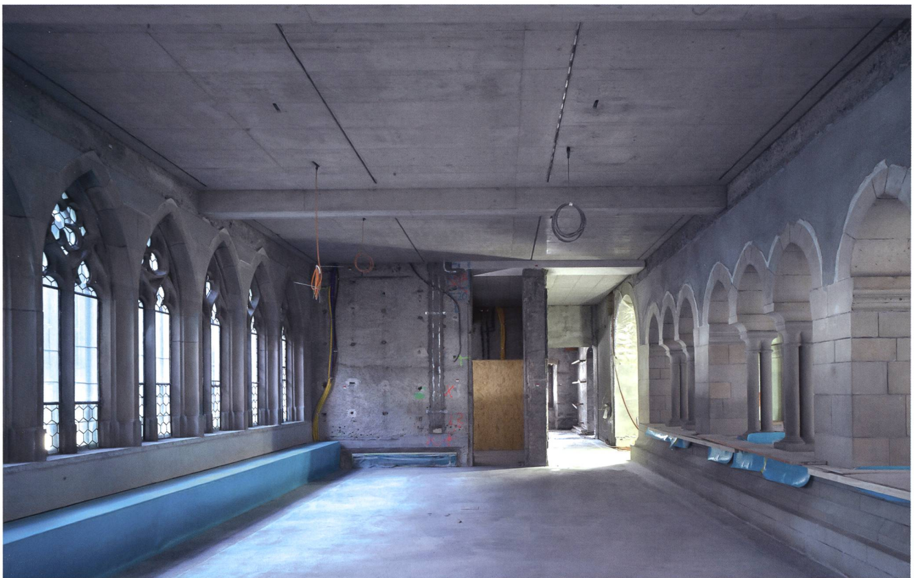
Abb. 27 Neu betonierte Decke und mit Beton ummantelte Stahlträger nach der Sanierung. Oberer Kreuzgang, Landesmuseum Zürich.
