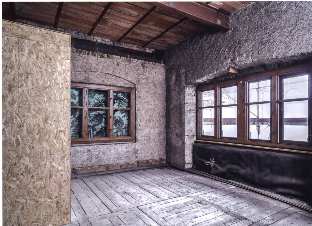
Abb. 21 Komplett verlegter Blindboden, der direkt auf dem Betonboden des Rohbaus aufliegt. Seidenhof-Stube, Landesmuseum Zürich.
