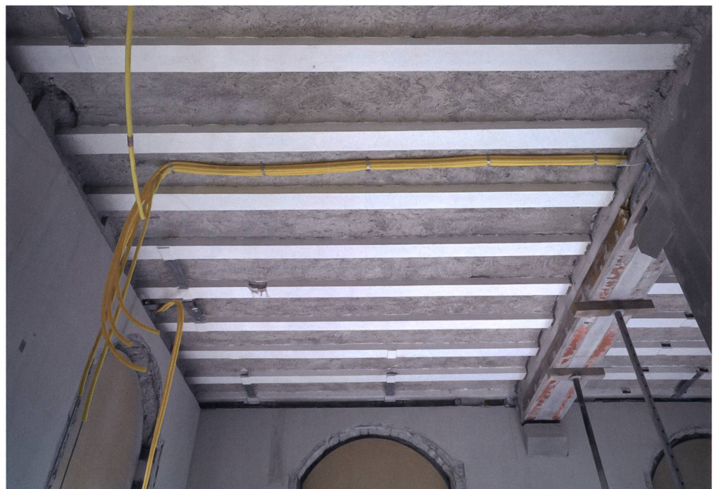
Abb. 29 Neu betonierte Decke und mit Spritzputz als Brandschutz ummantelte Stahlträger nach der Sanierung. Raum Korridor 00.102.H, Landesmuseum Zürich.
