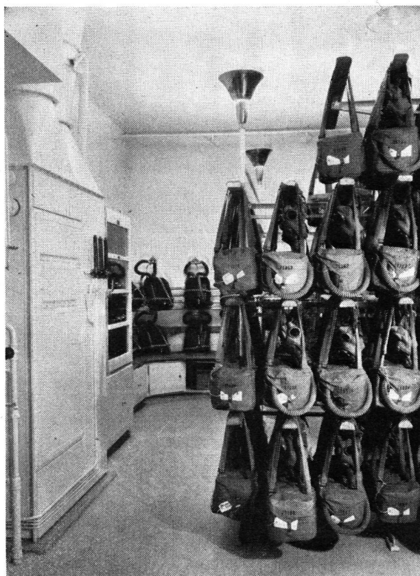
Geräteraum. Gut sichtbar ist die zwangslose Lagerungsart der Masken und Schläuche auf dem Bilde rechts. Ein Teil der Masken ist für die Abendübung bereits verpackt. Es ist unzulässig, die Masken im Sack zu lagern. Links ist die Konditionierungsanlage sichtbar mit den drei Rheostaten. Daneben der Formalindesinfektionsschrank. Im Hintergrund die Sauerstoffgeräte. Man beachte die Säulenlampen für die indirekte Beleuchtung.
