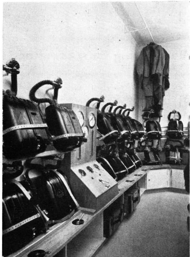
Geräteraum. Lagerung der Sauerstoffgeräte und Dräger-Grossdichtprüfanlage. Die neben dem Dichtprüfer gelagerten acht Geräte können direkt angeschlossen und geprüft werden. Man beachte die zwanglose Lage der Atemschläuche. Unten: Schränke und Regale für Kalipatronen, Sauerstoff-Flaschen und Werkzeugkasten. An der Decke das Traggestell für die Yperitkleider.
