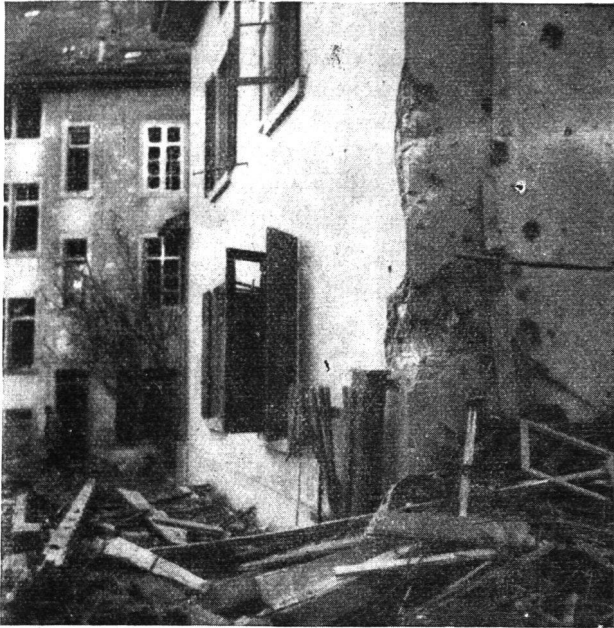
Bild 2. Splittereinschläge an einem Haus in 35 m Entfernung von der Einschlagstelle.
