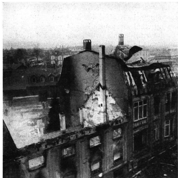
Abb. 9. Zens.-No. IV St 1195 Ausgebranntes Geschäftshaus.
