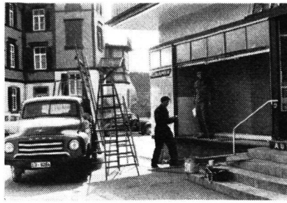
Das Leben geht weiter. Die zahlreichen geborstenen Schaufensterscheiben werden wieder ersetzt. Ein Bild aus Sarnen.
