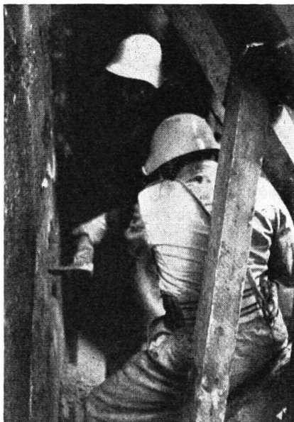
Das weitere Vordringen zu den Verschütteten wird durch eine Mauer behindert. In der Enge dieses schmalen Durchganges bemühen sich zwei Kameraden, die im Wechsel abgelöst werden, einen Mauerdurchbruch zu schlagen.
