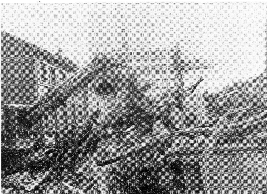
In einer zweiten Phase der Ausbildung werden auch moderne Baumaschinen eingesetzt, welche die Trümmerberge abtragen, Durchgänge in die eingestürzten Häuserreihen reißen und der Truppe ermöglichen, rasch an verschüttete Kellerräume heranzukommen und Menschen zu bergen.
