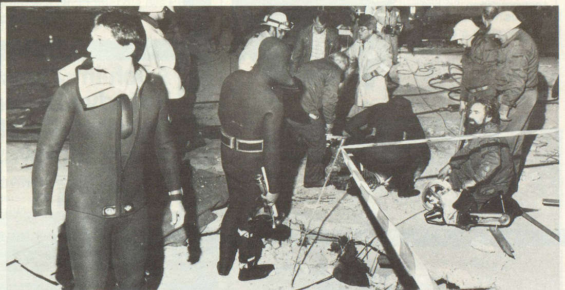
Zivilschutzangehörige sind daran, in die heruntergestürzte Decke Suchlöcher zu bohren.
