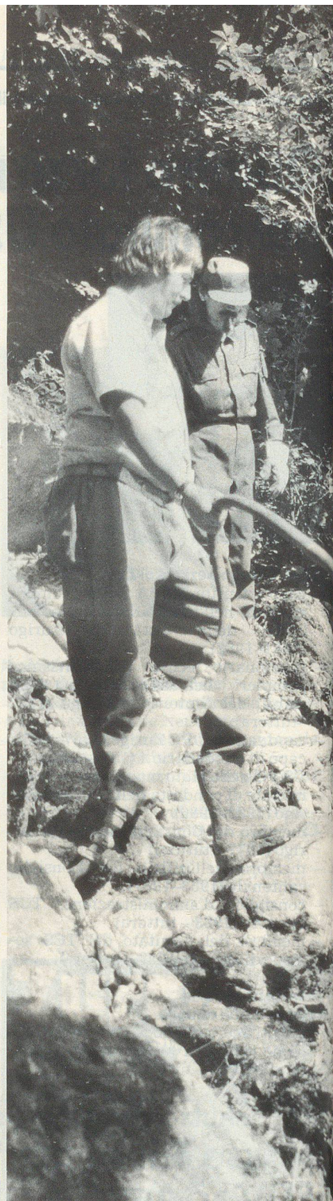
Mit Bohrhämmer werden die grössten Steinbrocken zerkleinert, damit sie für eine Bachverbauung verwendet werden können.
