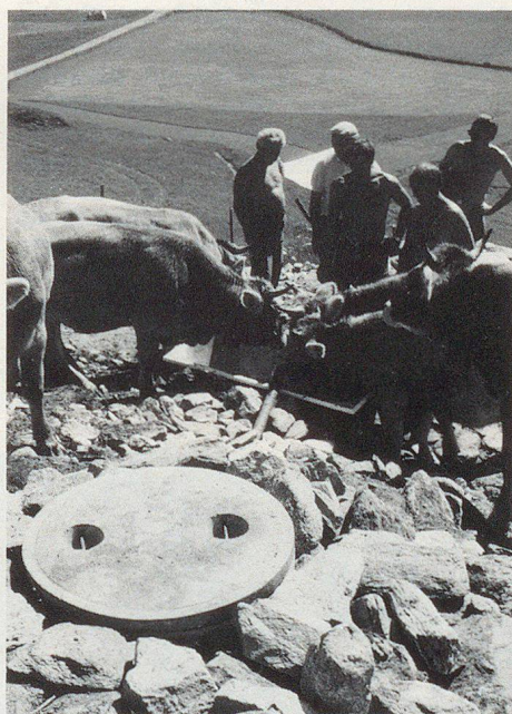
Es funktioniert: Via Druckreduktionsschacht haben die Kühe wieder Wasser.
