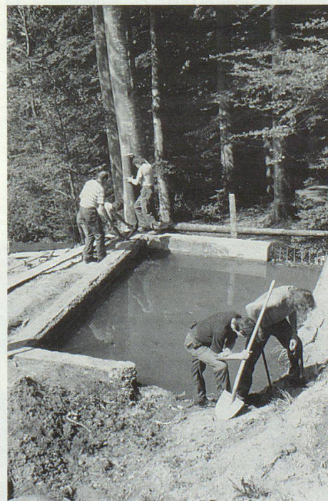
Am Greulenbach oberhalb des Riedlis wird ein Schlammssammler eingezäunt.
