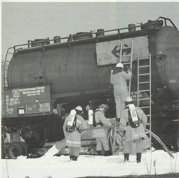
Une équipe pose un tapis de mousse de protection avant le colmatage d'une fuite...
