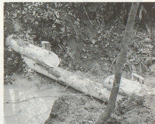
Eine der fachgerecht erstellten Bachverbauungen.
