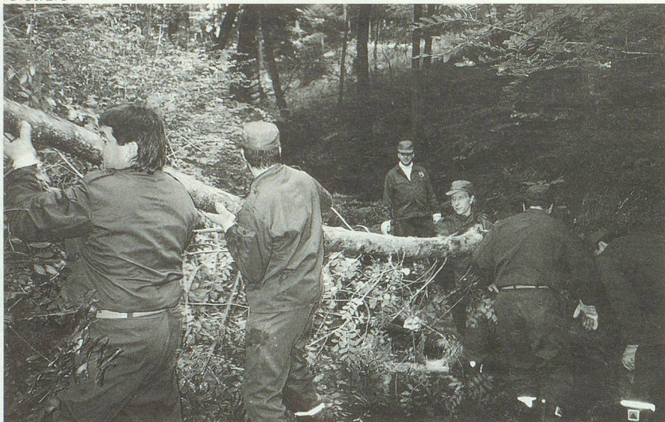
Das Bachbett musste von Baumstämmen und Geschiebe befreit werden.
