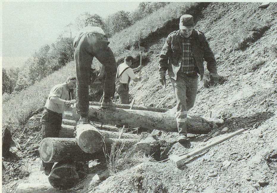
Holzverbauungen sichern einen rutschgefährdeten Steilhang.
