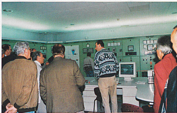
La salle de commande.
