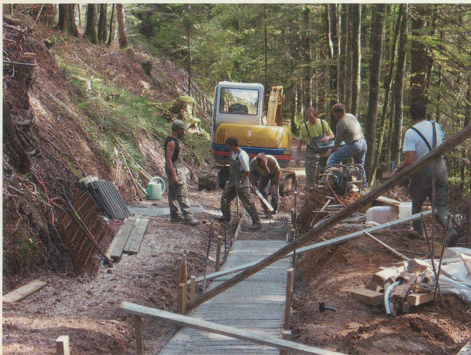
Mit dem Einbau einer Fahrrinne im steilsten Stück zur Wideregge wird das Befahren auch bei schlechtem Wetter sicherer.
