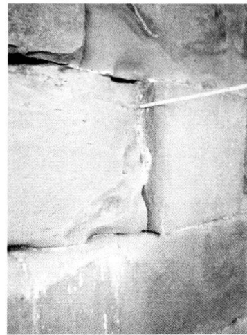
Schadenbild an der Nydeggbrücke (der Massstab zeigt eine Verwitterungstiefe von 8 cm).
