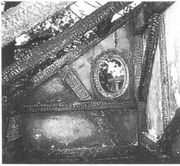
Alpeneggstrasse 10: Ausgebranntes Dachgeschoss mit statisch tragfähig gebliebener Holzkonstruktion.
