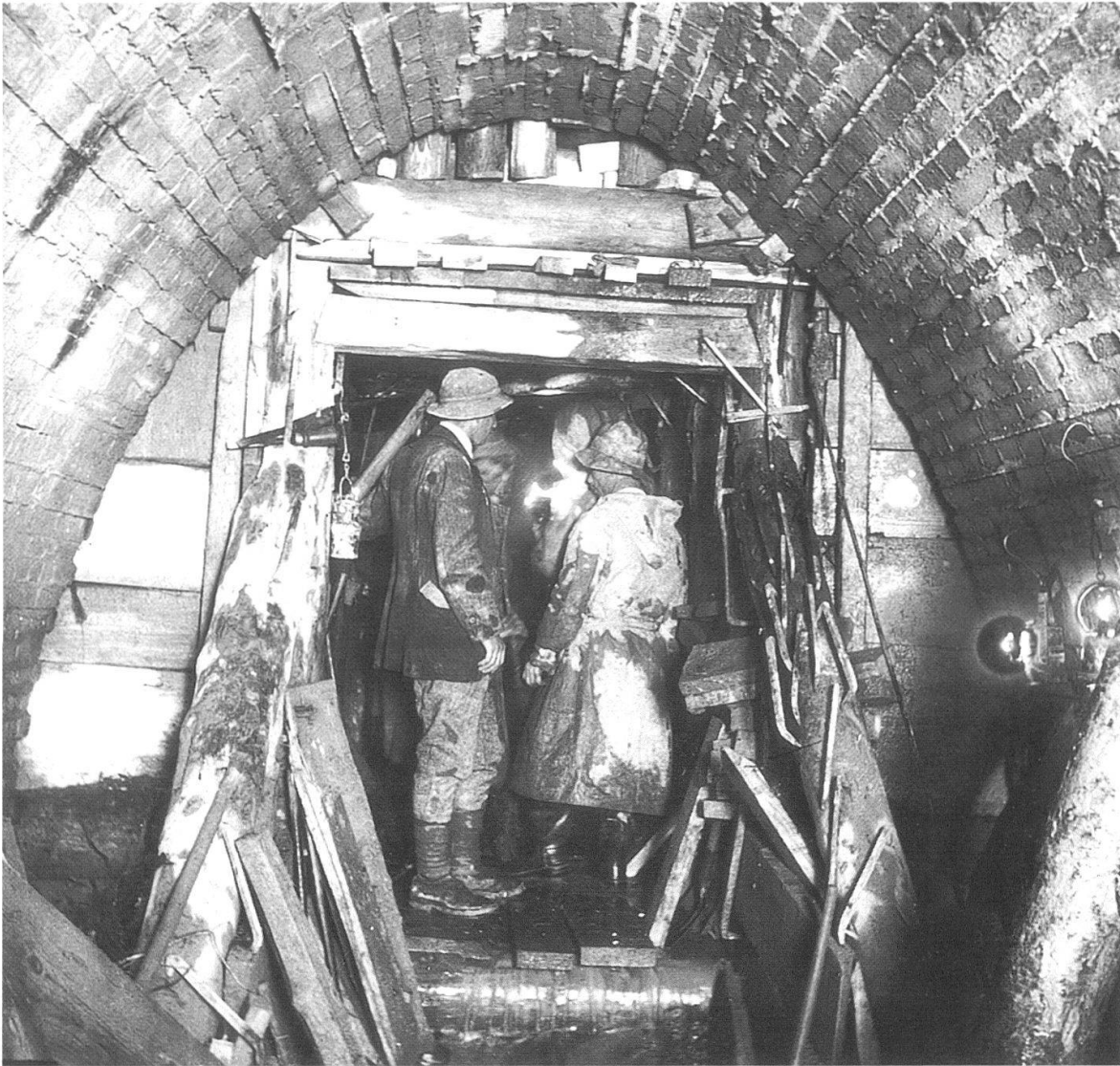
Abb. 8 Ein markantes Grossprojekt des Tiefbauamtes der Stadt Bern war der zwischen 1923 und 1926 erstellte, 1040 Meter lange Sulgenbachstollen. Dank diesem gelangte das Abwasser aus dem westlichen und südwestlichen Teil der Stadt erst unterhalb der Lorrainebrücke in die Aare, was die Verunreinigung des Aarewassers zwischen Marzili und Lorraine stark verminderte. Die während der Bauarbeiten entstandene Foto zeigt eine Innenansicht des Stollens und verdeutlicht dessen ausserordentliche Grösse.
