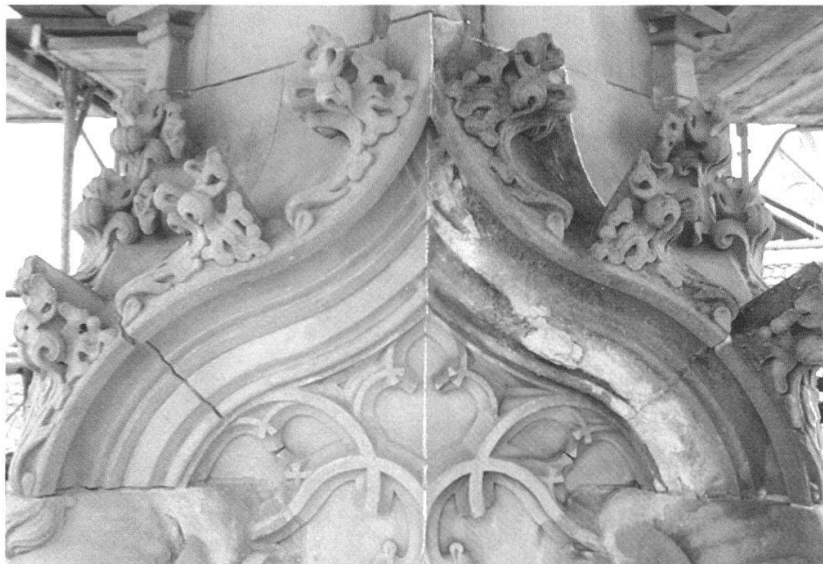
Münster: Westwerk Eckfiale Süd, unterer Fialengiebel. Rechts Vorzustand, links Zwischenzustand nach Reinigung, Konservierung und Aufmörtelung.
