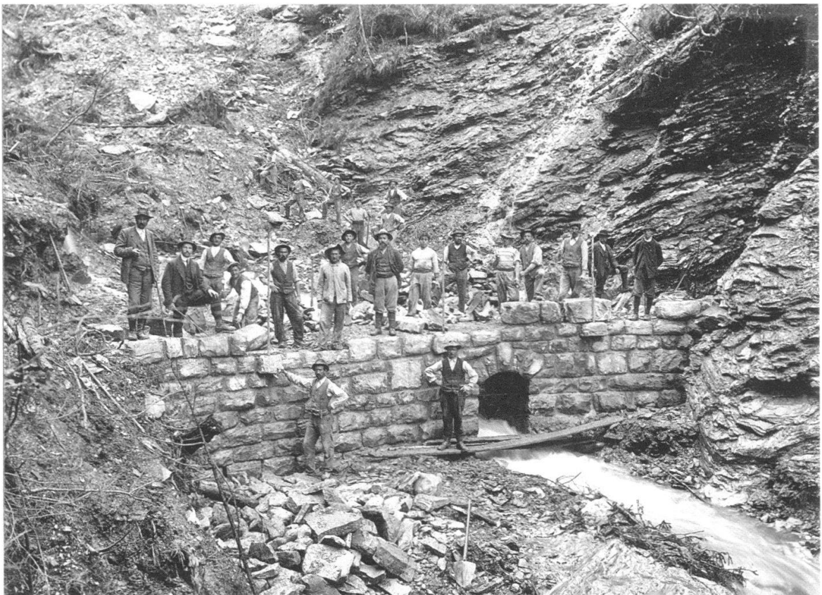
Abb. 8 Arbeiter beim Bau einer Sperre für einen Wildbach um 1910. Im Hintergrund lauert die Wildnis des Bachbettes, im Vordergrund herrscht Ordnung. Die Natur zu beherrschen, bedeutete Fortschritt und war für die Sicherheit der BLS-Strecke wichtig.
