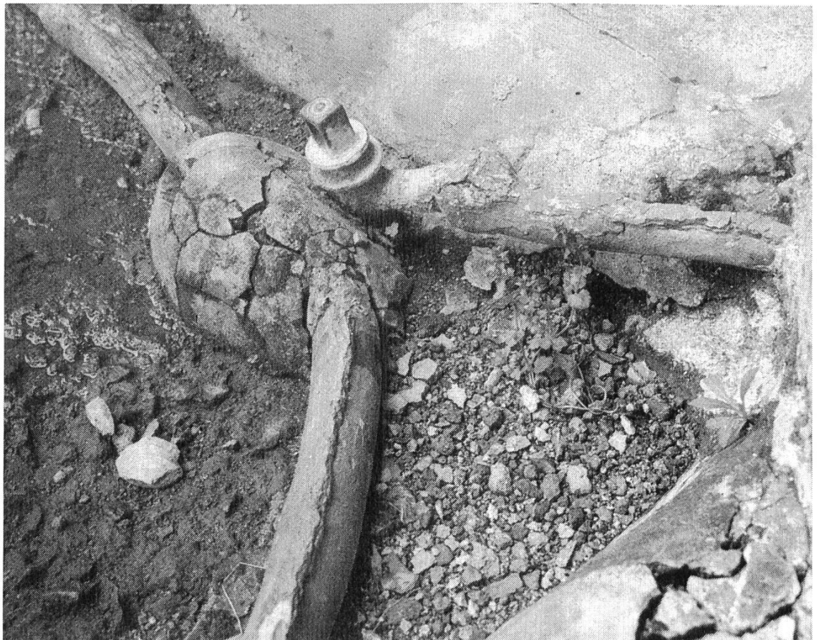
Abb. 2 Römische Bleileitung mit Absperr- hahnen, mit Vierkant- schlüssel zu bedienen (Villa Vettii, Rom)
