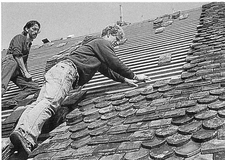
Abb. 2 Die Dachdecker beim Legen des Rautenmusters aus alten und neuen Ziegeln auf dem Dach der Niklauskapelle 1989.
