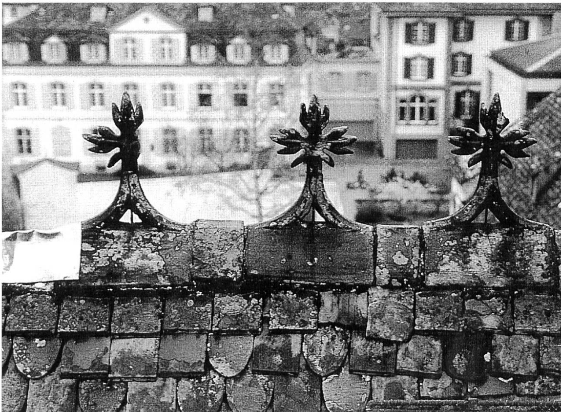
Abb. 5 Niklaus- kapelle: Alte Firstziegel vor der Renovation.
