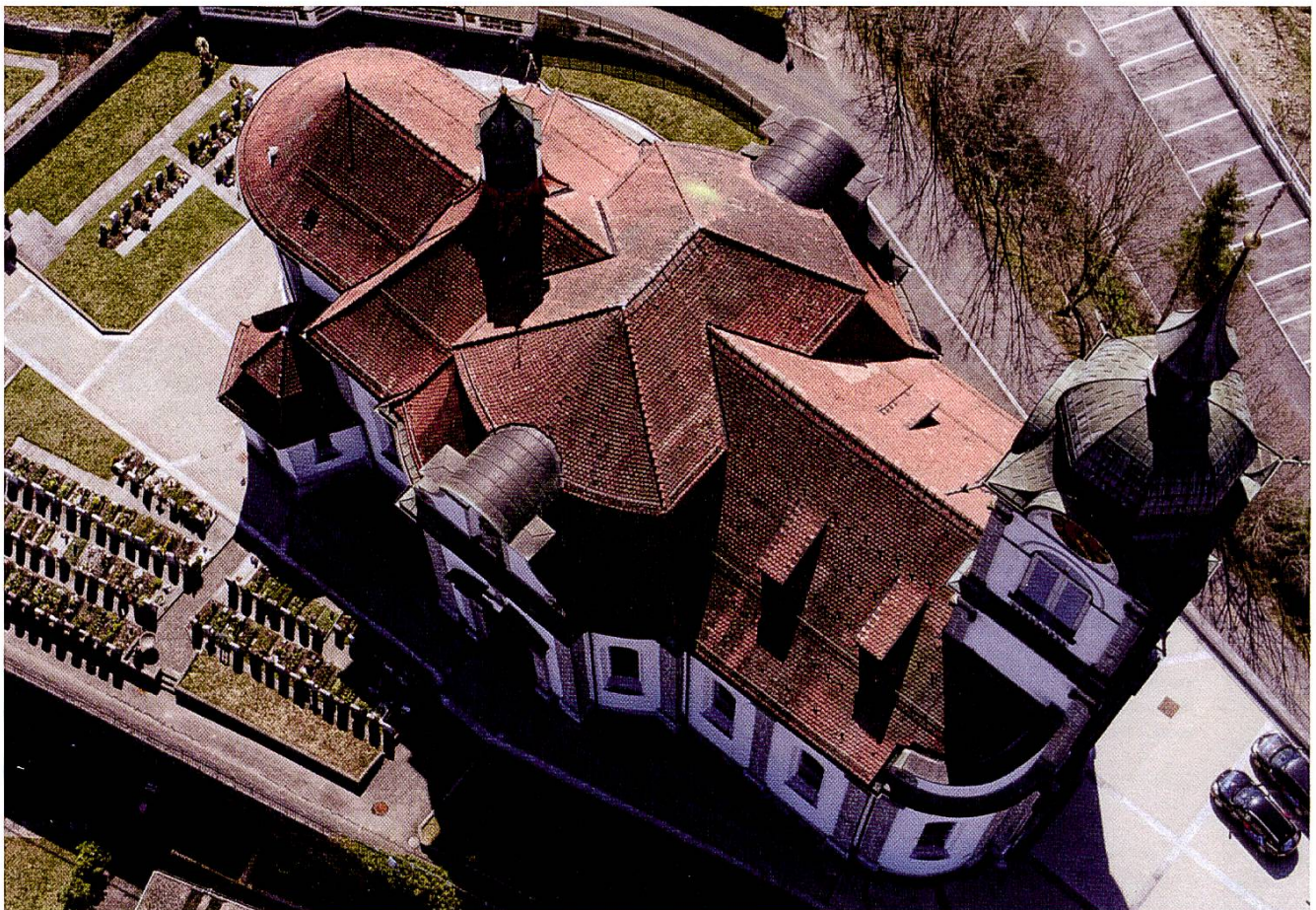
Kirchendach Schindellegi SZ 2008, vor der Sanierung 2016. Zusendung von dipl. Arch. Urs Züger, Pfäffikon SZ
