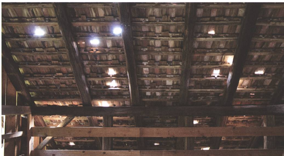
Licht dringt durch das vom Hagel beschädigte Dach der Ziegelhütte.
