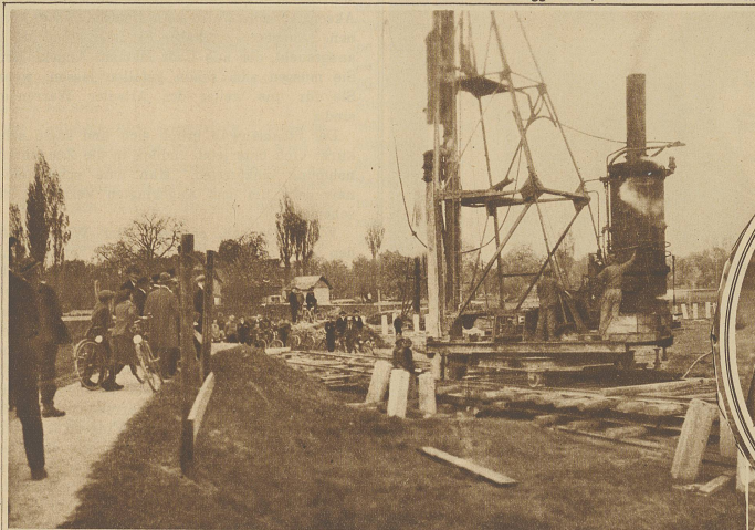
In Altenrhein bei Rorschach erstellen die Dornierwerke auf Schweizergebiet eine große Flugzeugfabrik. Mit dem Bau der riesigen Halle ist schon seit einiger Zeit begonnen worden. Unser Bild zeigt die »Dampfkatze«, die zur Fundamentierung der Halle 16 Meter lange Betonpfähle in den weichen Boden rammt
