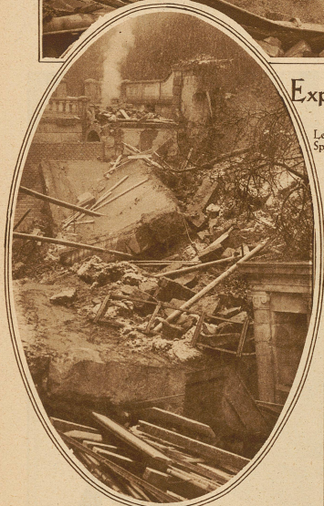
Beim Neubau in den Gartenanlagen der Villa Sumatra in Zürich ereignete sich Freitag früh ein großer Mauersturz, der, wenn er während der Arbeitszeit erfolgt wäre, wohl ein schweres Unglück zur Folge gehabt hätte
