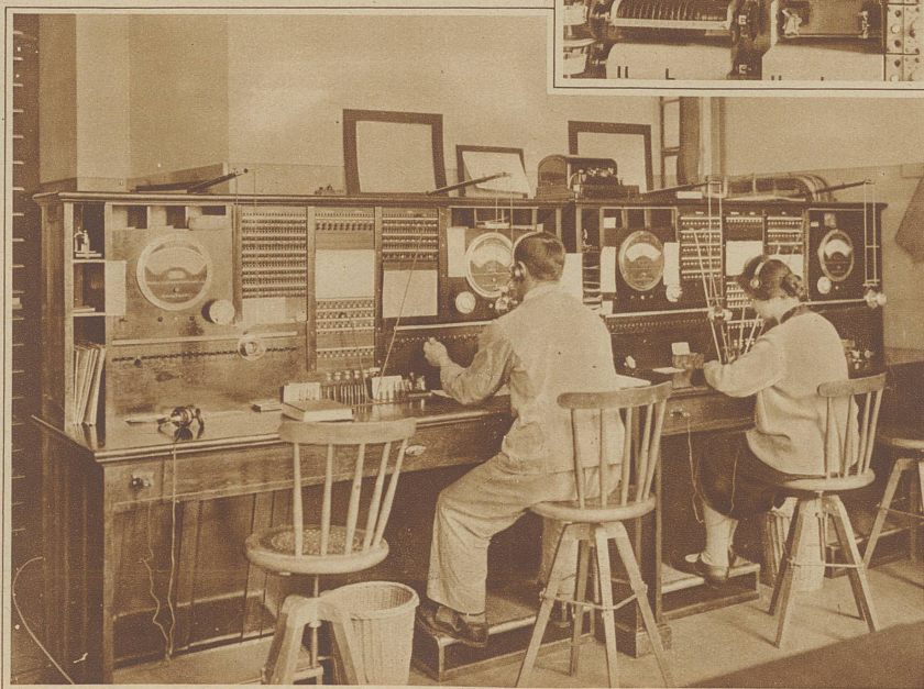
Bild rechts: Prüfstände im Störungsbureau. Entgegennahme von Störungsmeldungen. Prüfung und Messung von gestörten Teilnehmeranschlüssen
