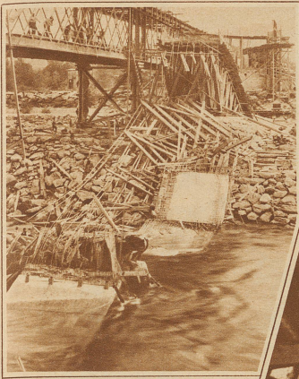
Nach dem Einsturz. Links steht die alte Eisenbrücke, die seinerzeit verschoben wurde, um der neuen Platz zu machen
