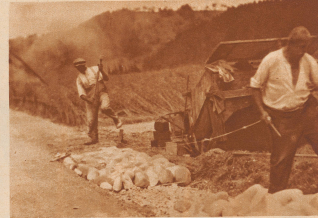
Auf der Landstraße gegen Willisau herrscht reger Betrieb. Dampfwaagen kurbeln und rumpeln über harte Steine. Arbeiter pikieren und hämmern, der hiesigen Straße ein neues Steinbett zu schaffen. Der Wanderer ruht sich und läßt sich von einem Straßenarbeiter über das durchgehende Straßenbetriebsverhältnis, den er gibt.
