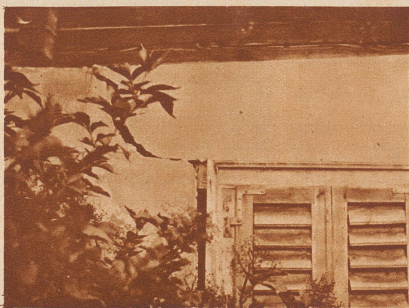
Der Schiefer, auf dem das Dorf abrutscht, ist nicht so glatt wie eine Schiefertafel. Da geht die Fahrt nicht immer ohne Risse und Sprünge in den Hausmauern ab. Aufnahmen Staub
