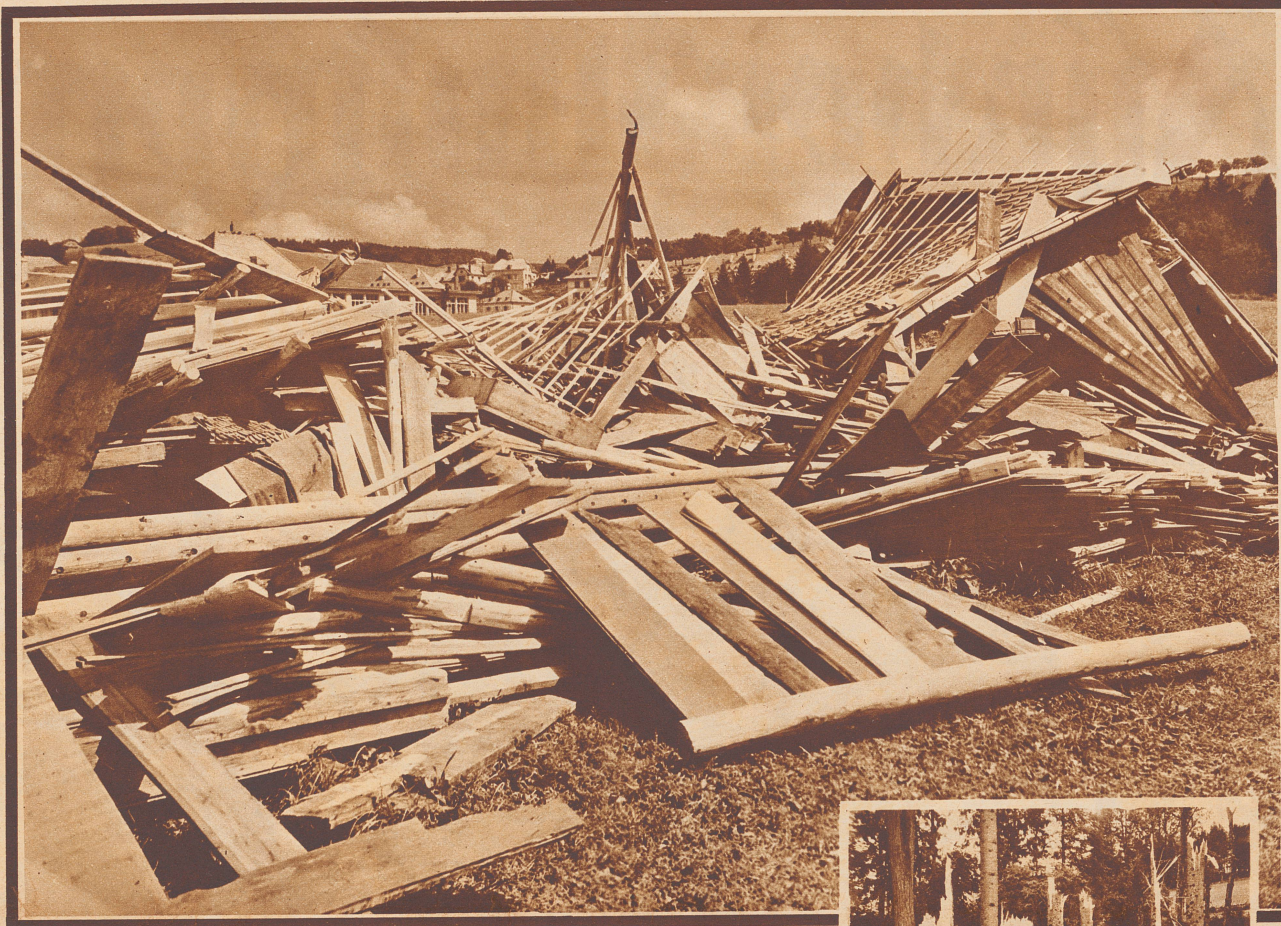
An der Straße von Le Locle nach Col-des-Roches wurde ein Magazin durch den Orkan vollständig zerstört. Inert einer halben Minute war das Gebäude umgelegt. Ein Bauarbeiter wurde durch den Einsturz schwer verletzt.
