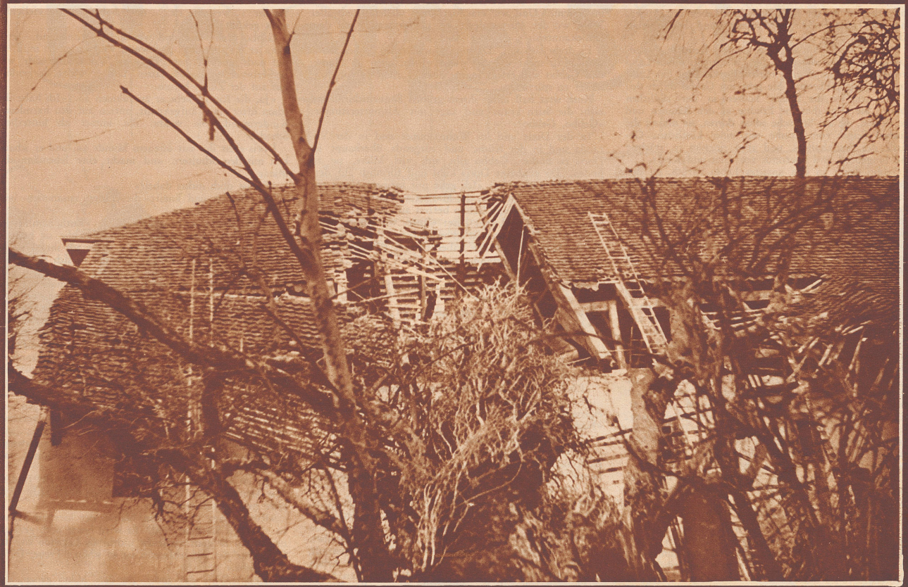
Ein Orkan von ungewöhnlicher Kraft fegte am 23. Februar über unser Land und über das ganze westliche Europa. In den Wäldern der Schweiz hat er böß gehaust und Tausende stolzer Tannen umgeworfen oder gebrochen. Deseleichen hat der Sturm viel Schaden an Gebäuden angerichtet. – Bild: Das Wirtschaftsgebäude des Schlosses Hilfkönig nach dem Unwetter. Aufnahme Pfister
