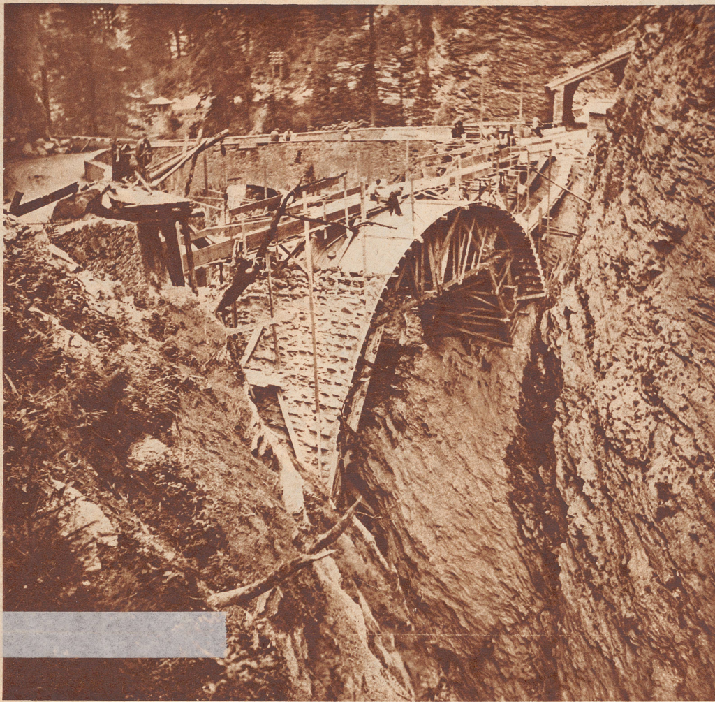
Die neue Brücke über die Viamala-Schlucht im Bau. Nicht wie die alte Brücke (im Hintergrund sichtbar) genau quer zur Schlucht, sondern schräg darüber gespannt, wird sie die Straßensektoren des rechten und linken Ufers in einer kurvenlosen Geraden verbinden – die einzige verkehrstechnisch richtige Lösung. Baukosten: 60 000 Franken.
