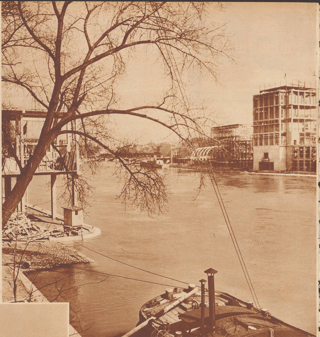
Riesenpaläste entstehen an den Seineufeln. Blick auf einen Teil des Ausstellungsgeländes. Links hinter dem Baum der deutsche Pavillon im Bau, rechts auf dem andern Ufer der Seine der italienische Pavillon. Das Schiff im Vordergrund dient den deutschen Arbeitern als Unterkunft.
