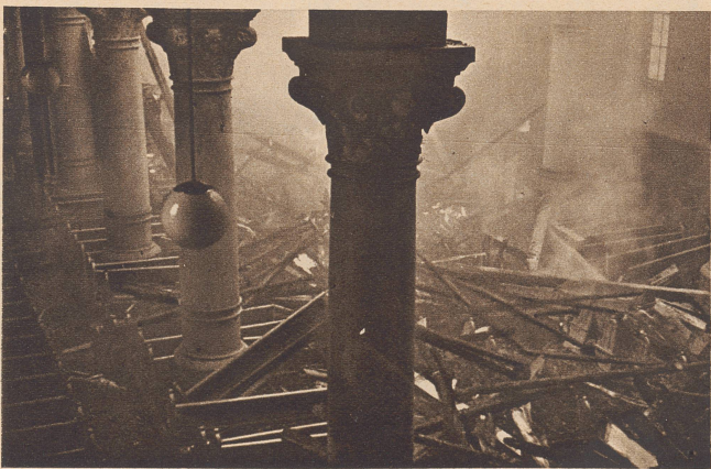
Die rauchenden Trümmer des eingestürzten Dachstuhls im Innern. Les débris fumants des combles, écroulés à l'intérieur de l'église.
