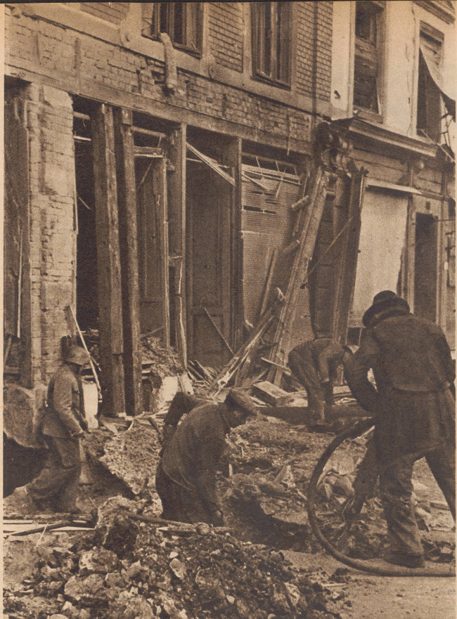
Ein Einschlag auf dem Winkelriedplatz im Gundeldingerquartier. Es entstand ein Trichter von 2—3 Meter Tiefe und 3 Meter Durchmesser. Mehrere Häuserfronten wurden schwer beschädigt. Im Hause Winkelriedplatz 1 wurde eine Damenschneiderin durch Bombensplitter getötet.
